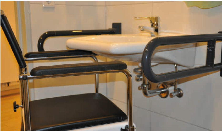
Auf dem Foto sehen Sie, wie ein Rollstuhl durch ein entsprechend ausgewähltes Waschbecken ohne Hinderung ganz nah herangefahren werden kann. Foto Bad „Leben in Schaffrath“
